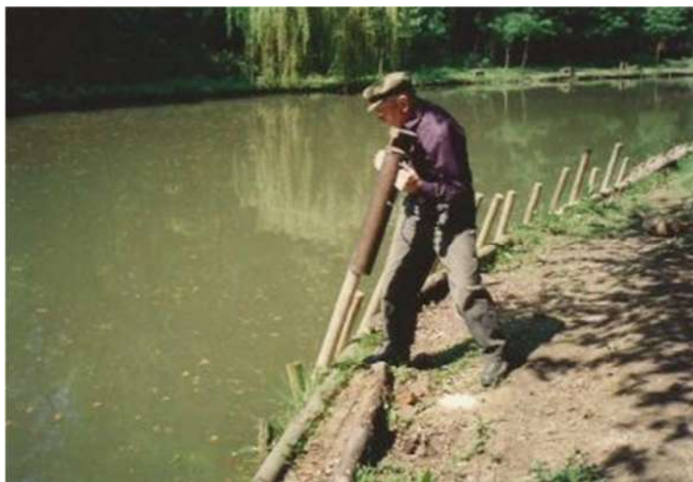
Travaux de restauration des berges de l'étang de pêche par Louis Draps.
